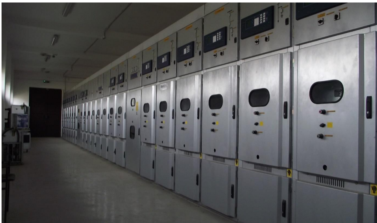
Sl.1 Postrojenje 20 kV TS 110/20/10 kV/kV/kV Jagodina 3
