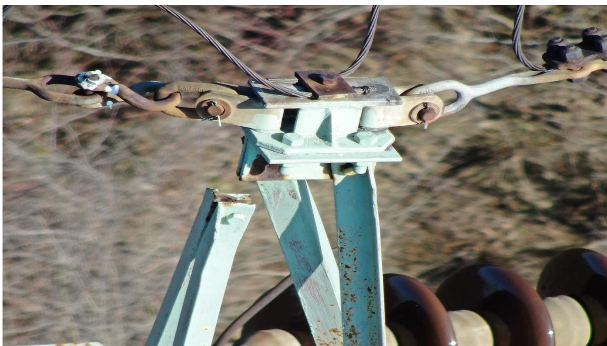
Slika 7: Oštećenje konstrukcije na DV 2x110 kV br. 136A/1 TS Beograd 3 – TS Beograd 11 i br. 136A/2 TS Beograd 11 – TS Beograd 17
