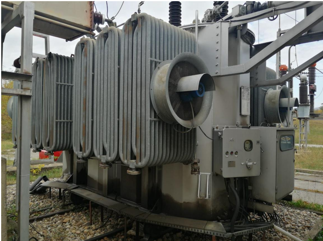
Slika 2: Posmatrani uljni energetski transformator
