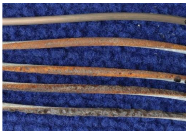
Slika 8: Kategorija težine oštećenja korozijom pojedinačnih čeličnih žica
