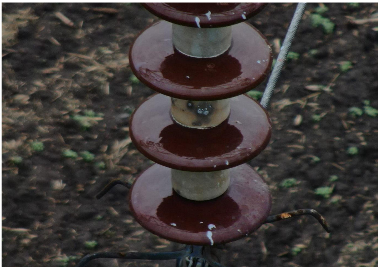
Slika 1: Tragovi preskoka na izolatoru na DV 110 kV br. 132/1 TS Sombor 3 – TS Crvenka
