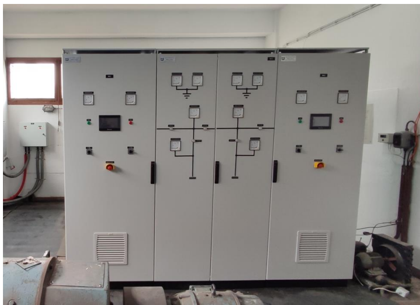
Slika 4. Novo postrojenje za napajanje elektrolizera.
