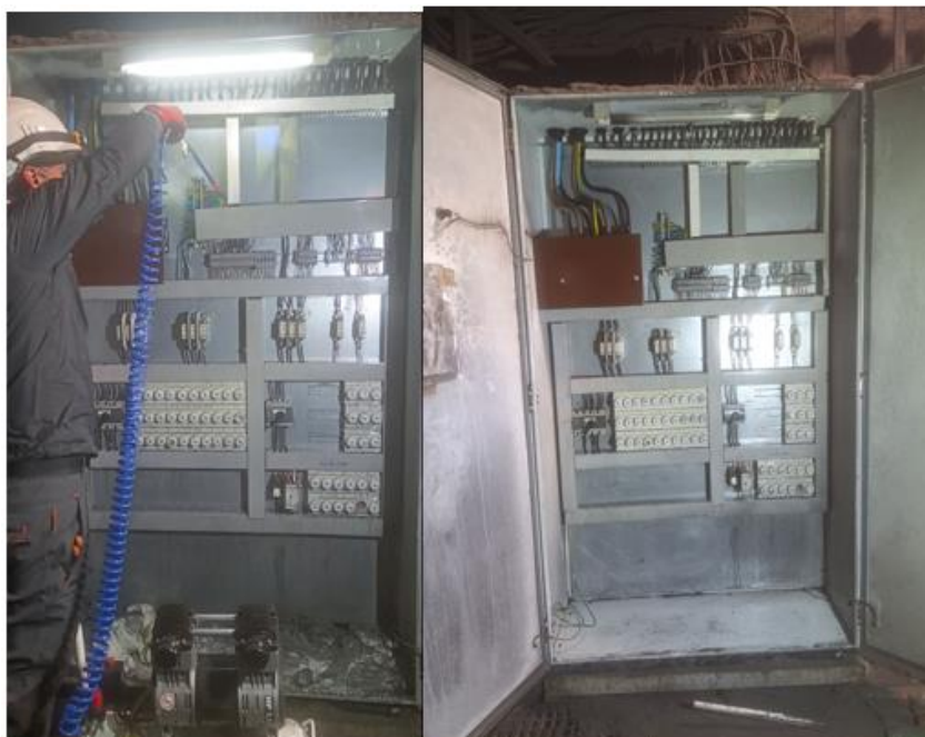
Slika 7: Sušenje i izgled unutrašnjosti ormara sopstvene potrošnje 0,4 kV
