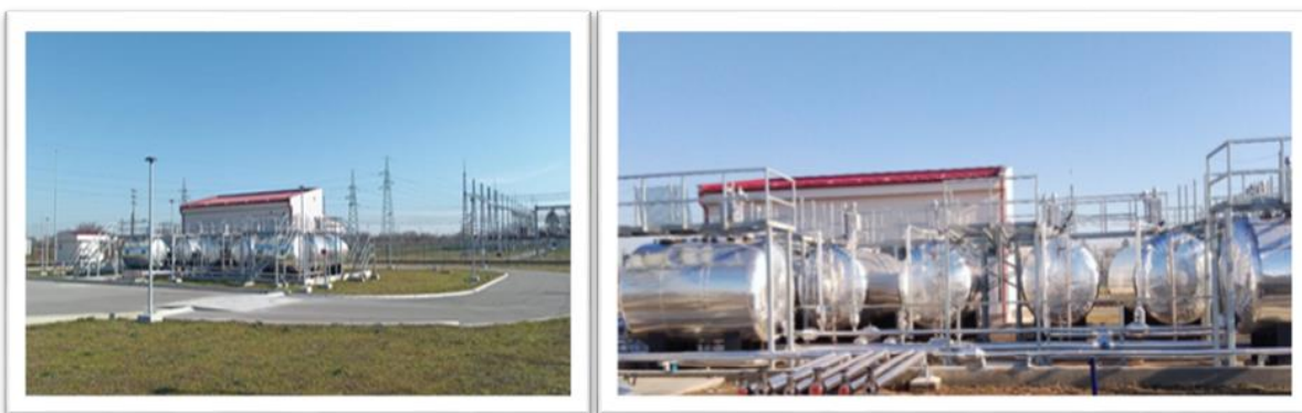
Slika 2: Spoljni prikaz kompleksa CUG sa infrastrukturom i instalacijama
