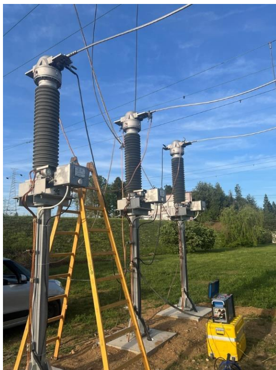
Slika 6: Optički strujni transformatori u polju E09 tokom ispitivanja
