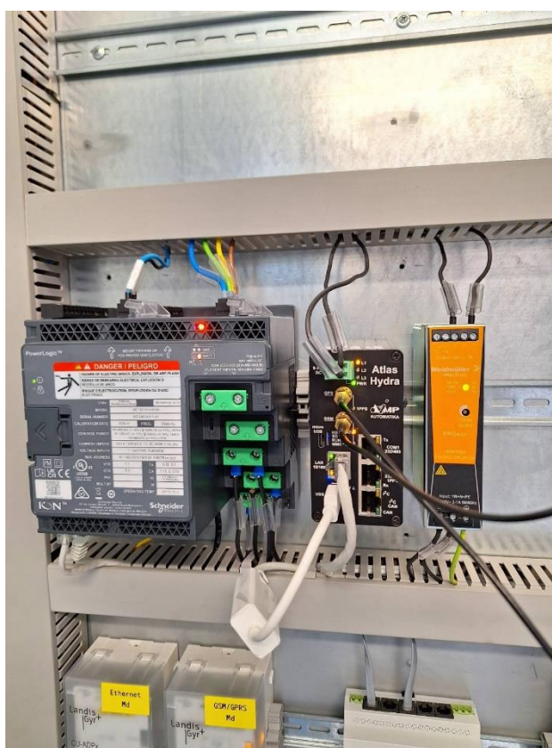
Slika 4: Izgled opreme postavljene u ormanu merenja
