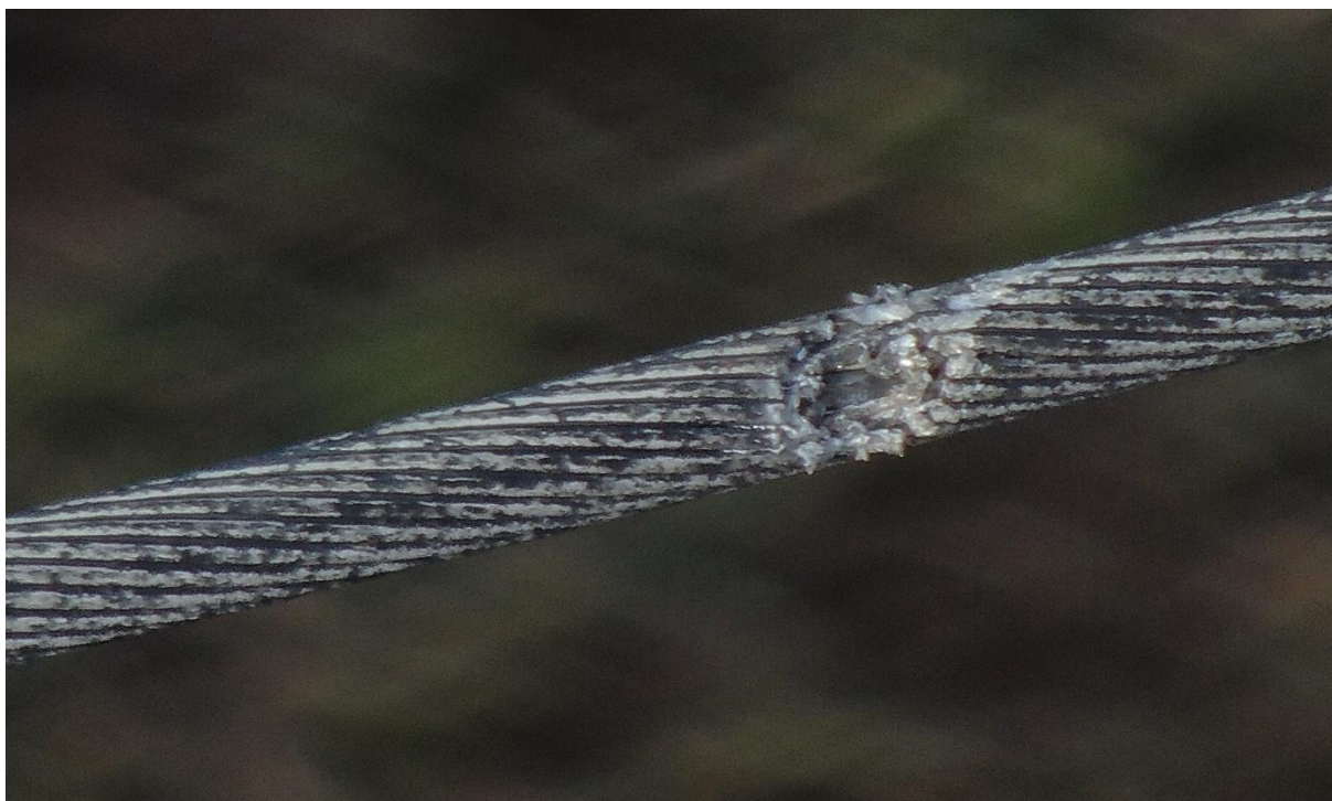
Slika 6: Oštećenje faznog provodnika na DV 110 kV br. 132/1 TS Sombor 3 – TS Crvenka
