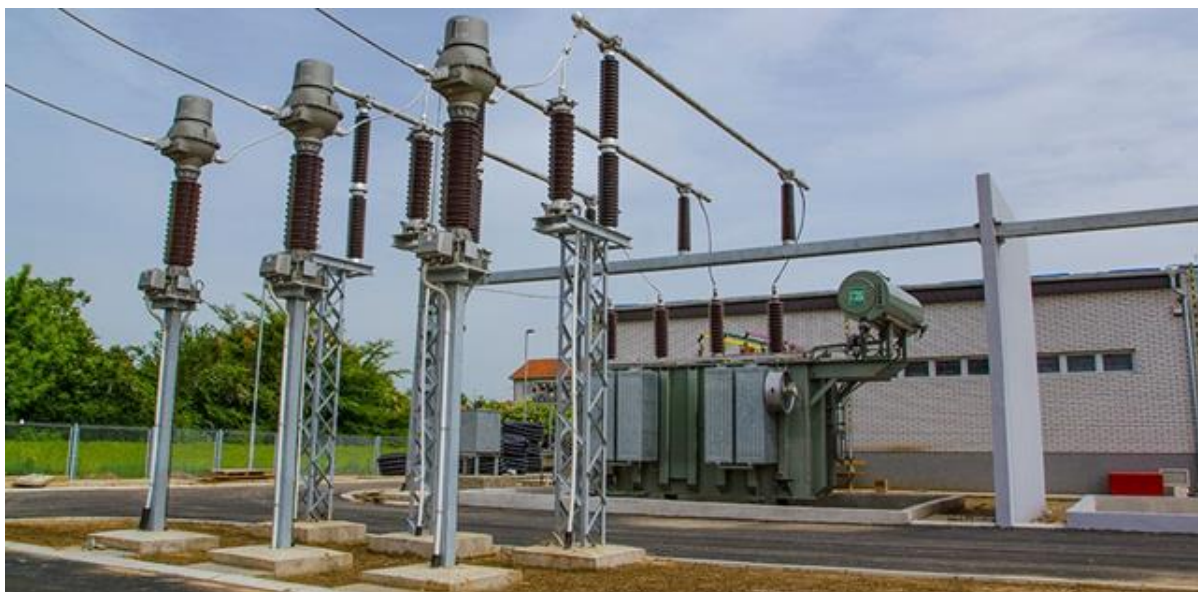
Slika 1: Deo postrojenja TS 110/10 kV
