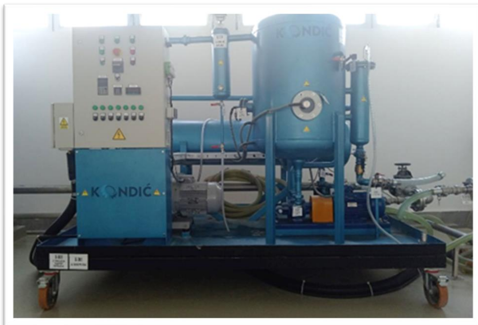
Slika 4: Postrojenje za obradu ulja
