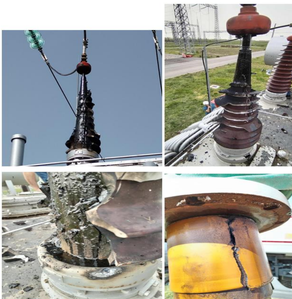
Slika 4: Havarisan provodni izolator
