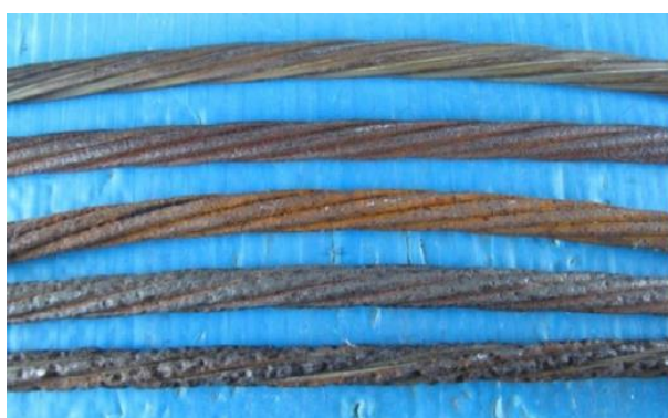
Slika 7: Kategorija težine oštećenja korozijom jezgra provodnika
