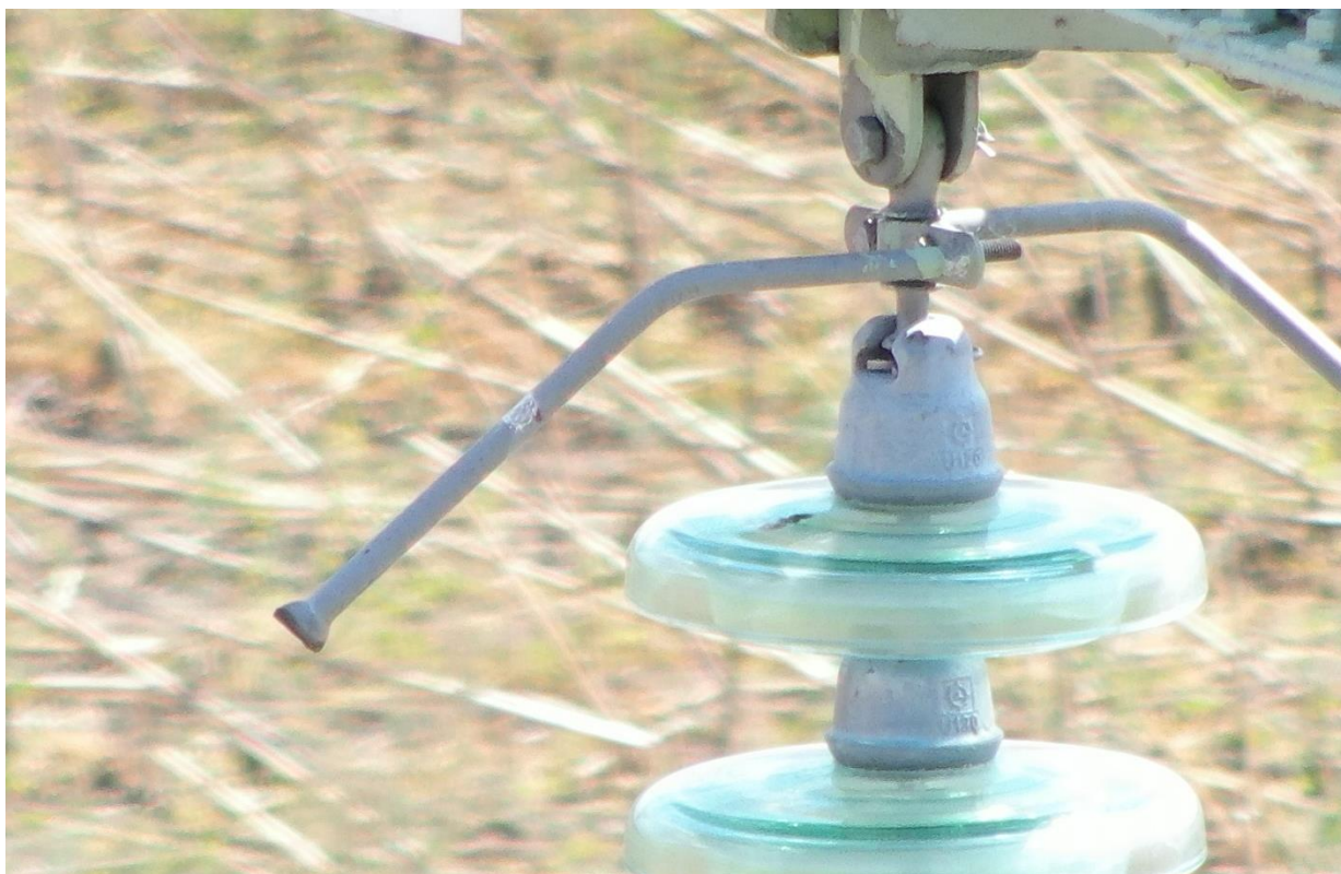
Slika 4: Oštećenje zaštitnog elementa (roga) izolatorskog lanca na DV 110kV br. 102A/2 TS Požarevac – TS Petrovac
