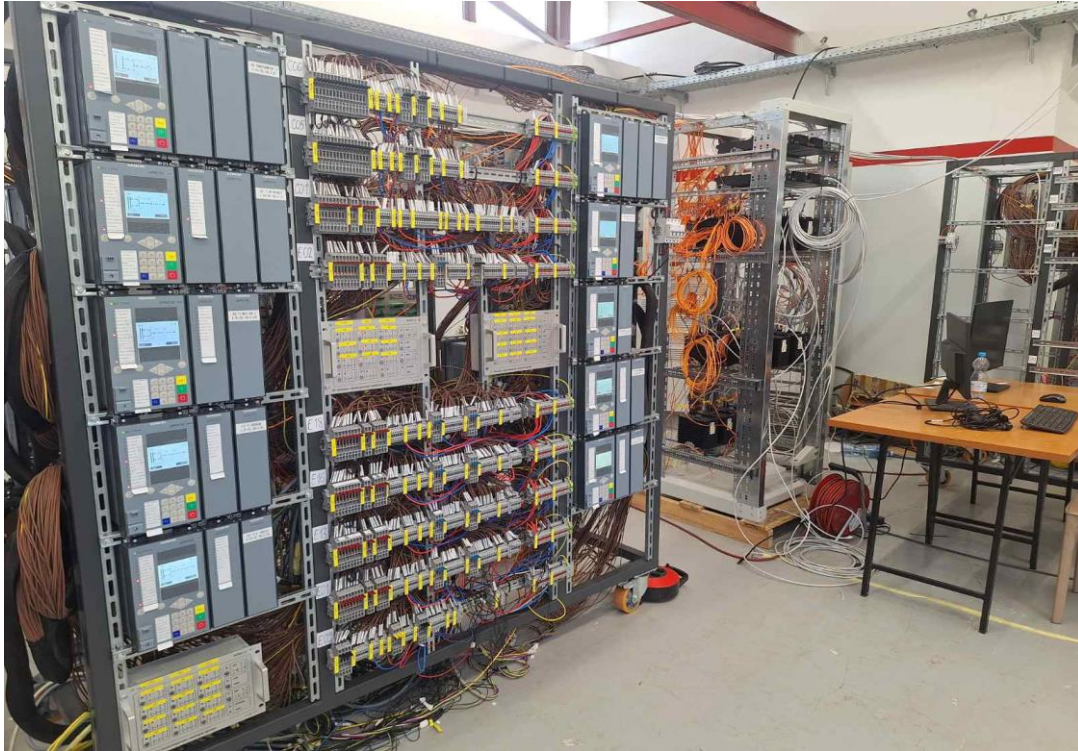
Слика 5.2.1: IED уређаји и симулатори примарне расклопне опреме на привременој носећој конструкцији.
